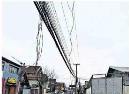
EL PELIGRO ES LATENTE ANTE LA PRESENCIA DE ESTOS CABLES.
