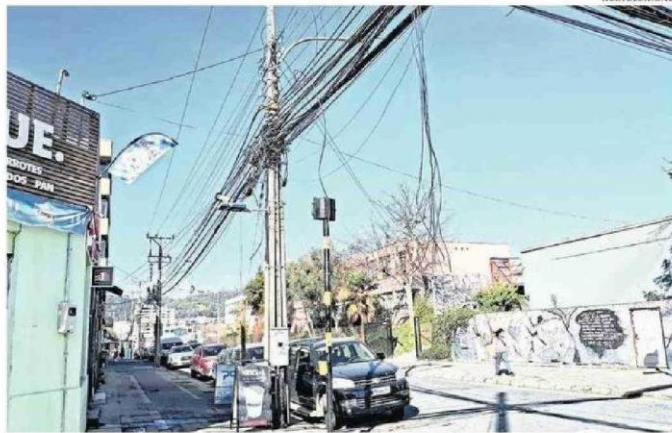
EN LA ESQUINA DE CAUPOLICÁN Y ROZAS, LOS CABLES ESTÁN A POCO MÁS DE UN METRO DEL SUELO.
