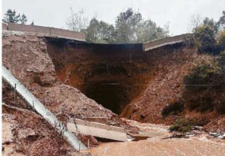
ZAPALLAR ESTUVO A PUNTO DE QUEDAR AISLADO POR SOCAVONES QUE AFECTARON SU CONECTIVIDAD.
