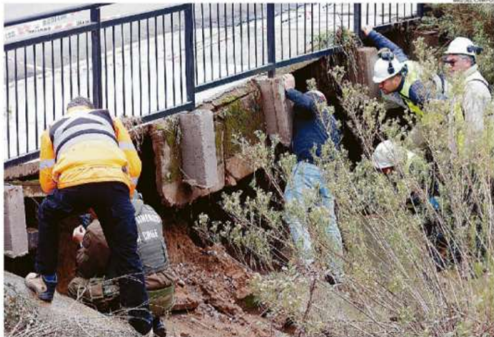
EN EL OLIVAR EL SOCAVÓN SE PRODUJO POR UNA FALLA DE LA EMPRESA EXTERNA A CARGO DE OBRAS, Y SE PUDO SOLUCIONAR FÁCILMENTE.
